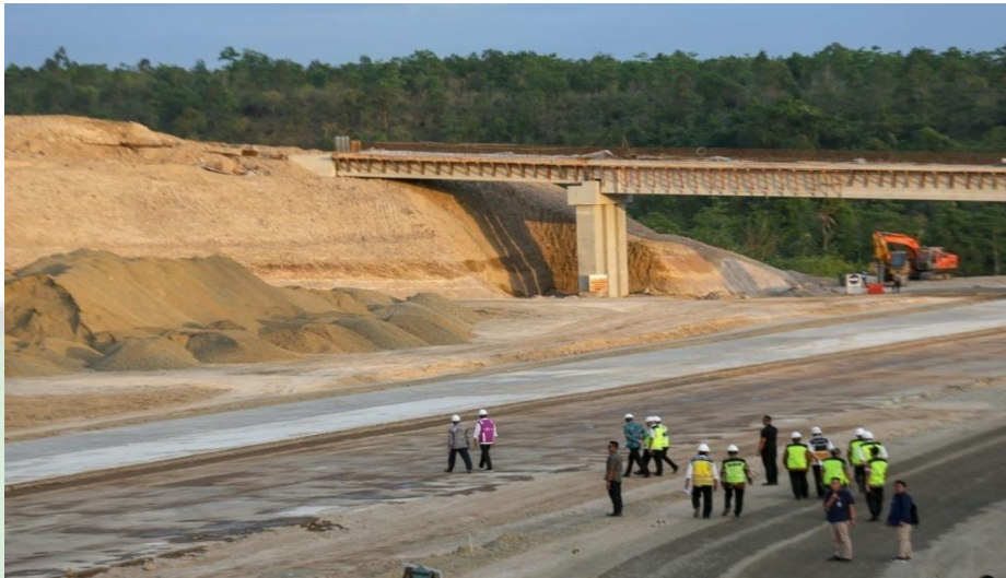
Gambar 4.1: Kondisi Jalan Tol di Zona Padang Tiji
