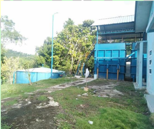
G.1 Instalasi Pengolahan Air Cabang Darul Hikmah
