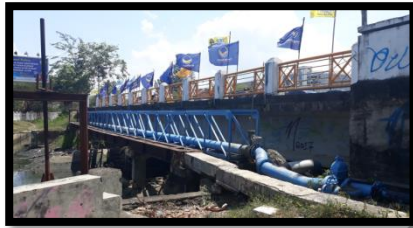
Gambar 4.8 pipa PDAM Sumber: dokumnetasi pribadi, 2018
