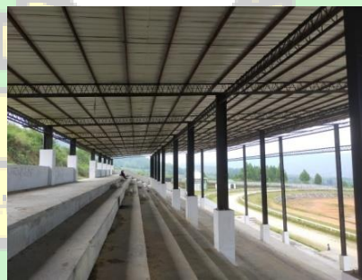
Gambar 5.19 : Kondisi Tiang Sumber : Dokumen pribadi
