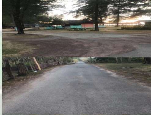
Gambar 4.3. Kondisi Jalan pantai Lampuuk
