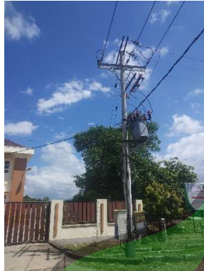
Gambar 4.6 Jaringan listrik dan telepon Sumber: Dokumen Pribadi, 2021
