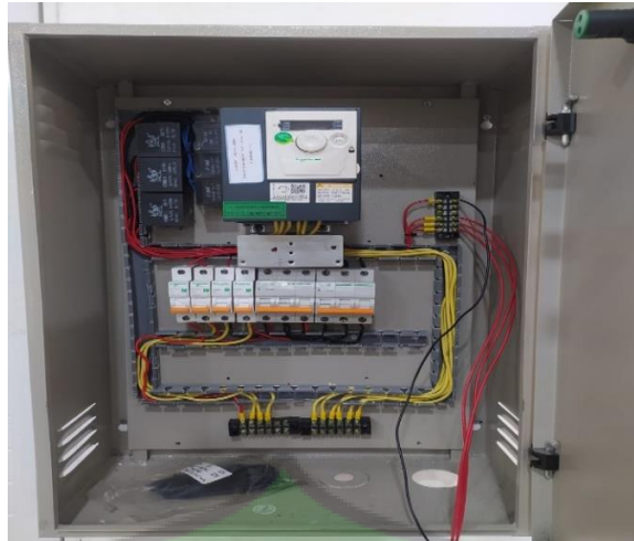
Gambar 3.3 Tampak rangkaian generator induksi 3 phasa
