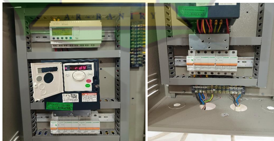
Gambar 4. 4 rangkaian VFD dengan motor induksi 3 phasa
