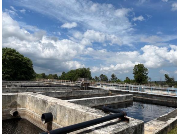
Gambar 2. 2 Kolam Stabilisasi pada LTP TPA Regional Blang Bintang
