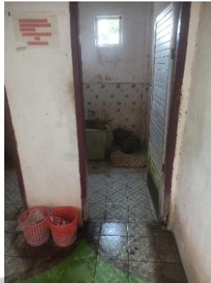
Gambar 1.4 Kondisi toilet yang memprihatinkan Sumber : Dokumentasi Pribadi, 2024
