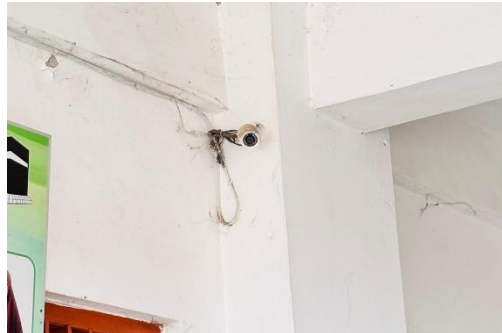
Gambar 2.1 Kamera Pengawas (CCTV)
