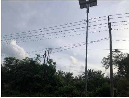
Gambar 4 13 Jaringan Listrik Negara Induk
