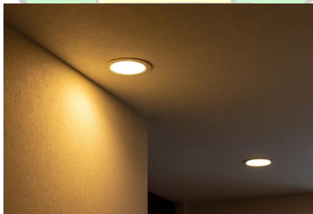
Gambar 2. 13 Down Light (arah cahaya kebawah)
