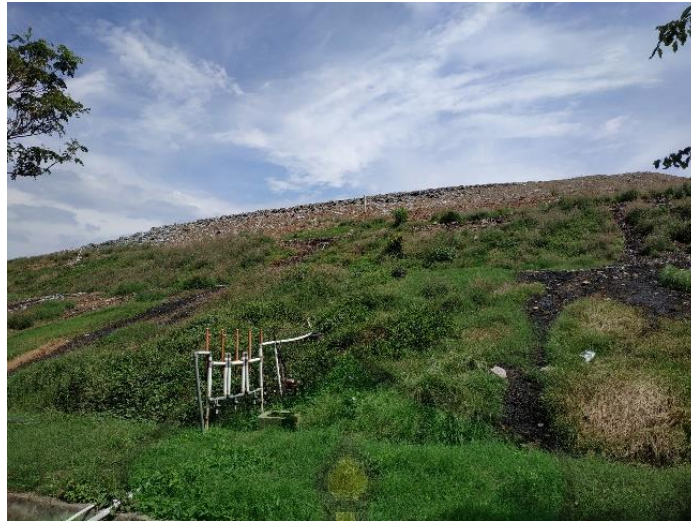
Gambar 4.16. Pipa penangkap gas yang terhubung ke ITF (Sumber : Dokumentasi Tugas Akhir, 2018).
