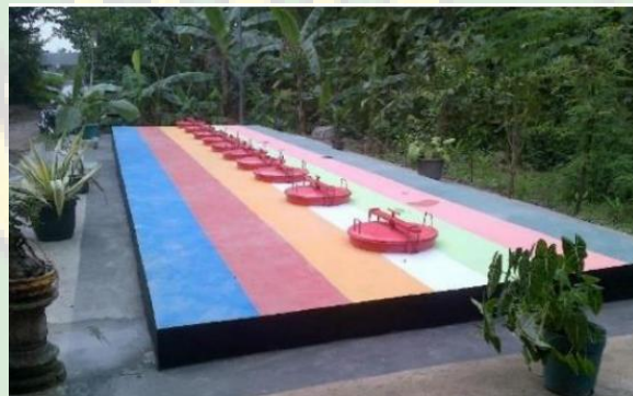
Gambar 5.38 Instalasi Pengelolaan Air Kotor (IPAL) Komunal
