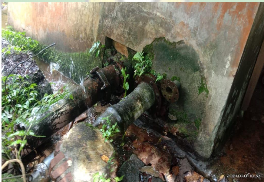
Gambar 4.3 Kondisi Pipa Transmisi
