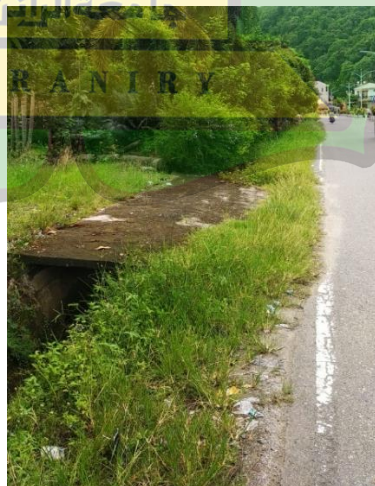
Gambar 4.16 Drainase Sumber : Dokumentasi Pribadi
