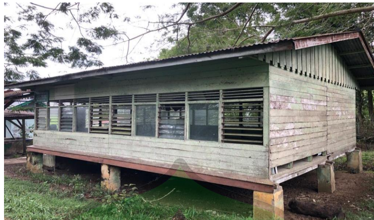
Gambar 6. Kondisi balai pengajian saat ini yang sudah tidak berfungsi. (Dok. Observasi Penulis 7 Februari 2022)
