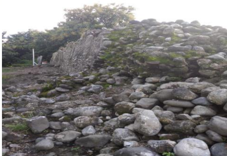
Foto 5: Sudut Benteng yang rusak
