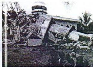
Gambar.3. Akibat Gempa Bumi
