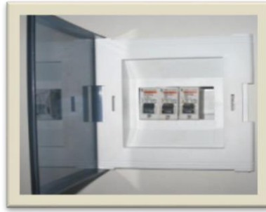
Gambar 2.8 Panel Hubung Bagi
