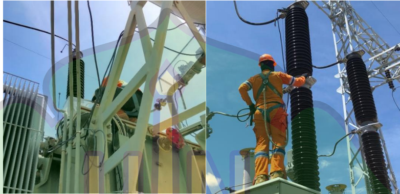
Gambar 4.6 Pemeliharaan Fisik Bushing Transformator
