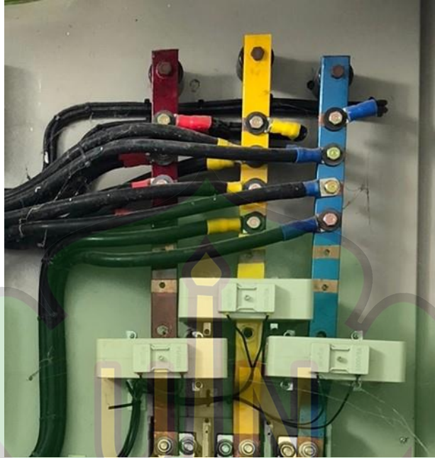
Gambar 4.4 Busbar pada panel
