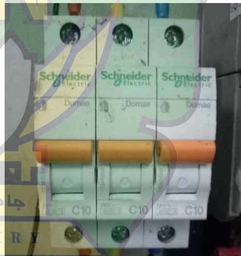
f) MCB untuk volmeter pada panel
