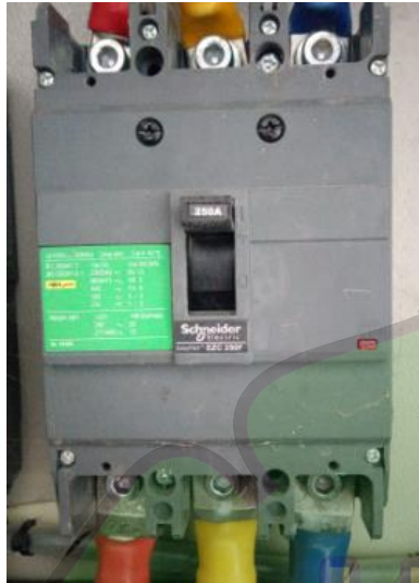
c) MCCB 250A untuk lantai 2
