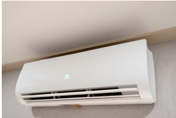
Gambar 5.32 Ac Sebagai Penghawaan Di Dalam Bangunan
