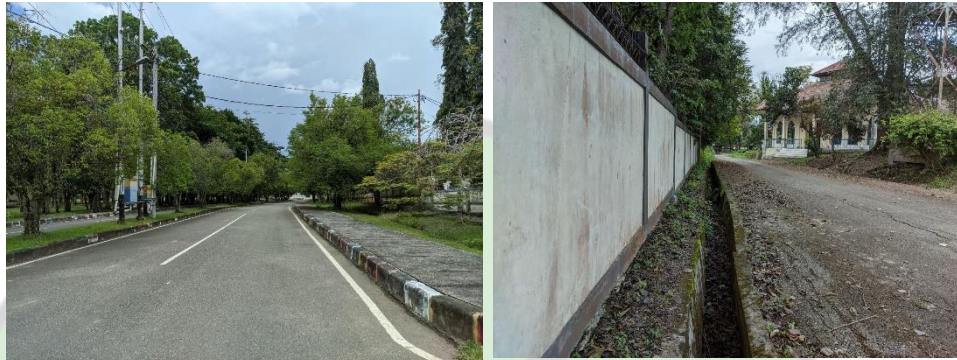
Gambar 4. 5 Eksisting Utilitas Sumber : Dokumen Pribadi
