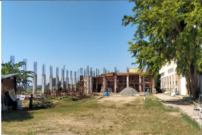
Dok. Bangunan Sekolah yang belum Rampung
