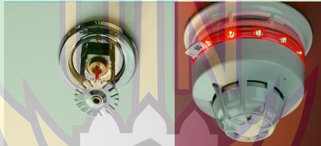
Gambar 5. 36 Sprinkler dan heat detector (Sumber: firehydrant.id)
