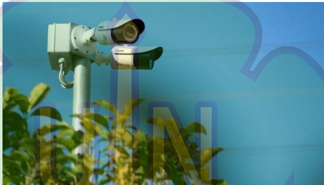
Gambar 5. 25 unit kamera cctv
