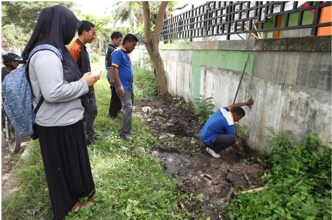
Foto ketika meninjau langsung lokasi kerusakan pada pipa
