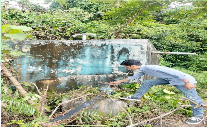
Sumber: Koleksi Pribadi. Saat Peneliti Melihat langsung lokasi tempat penampungan air bersih, 16 oktober 2025
