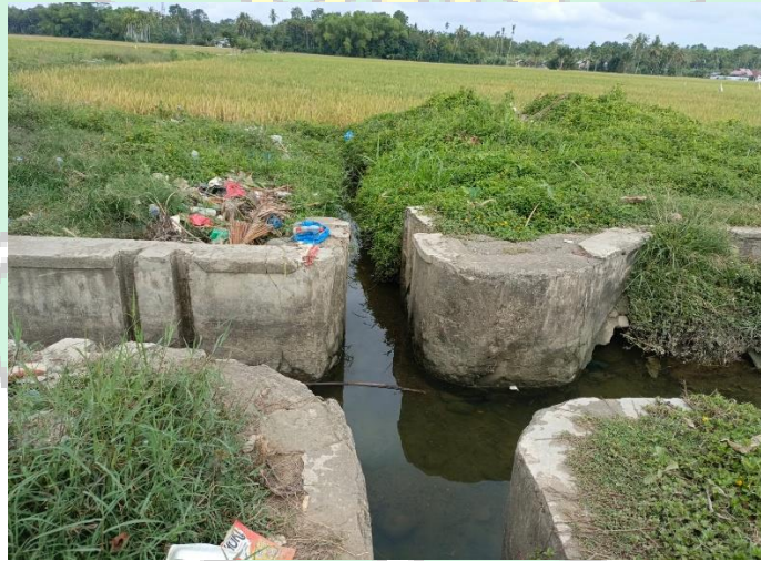
Gambar 4.9 Irigasi Lueng Beureueh di desa Cot Beringen yang sudah di renovasi Sumber: Dokumentasi pribadi 22 Agustus 2025
