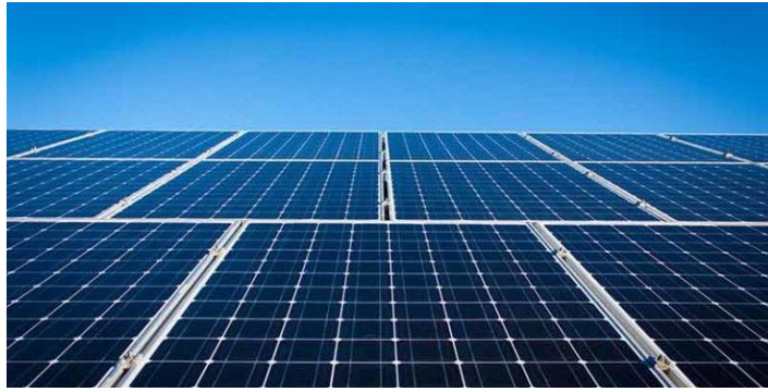
Gambar 4. 4 Solar Panel atau Photovoltaic Array (PV)
