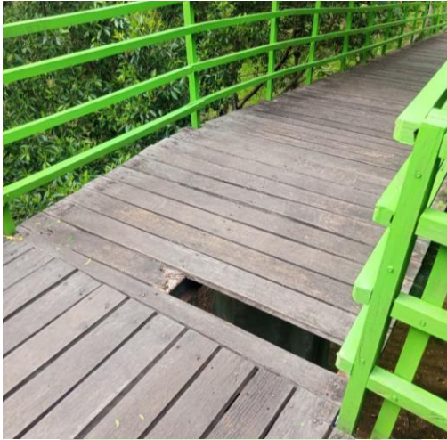
Gambar 1.1 Kondisi Jembatan Tajuk
