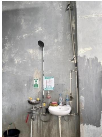
Gambar 4. 8 Fasilitas Tempat Cuci Tangan Dan Shower Darurat
