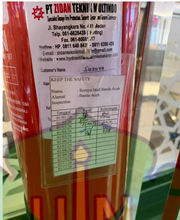
Gambar 4. 7 Inspeksi APAR existing Sumber : Hasil Observasi, 2026
