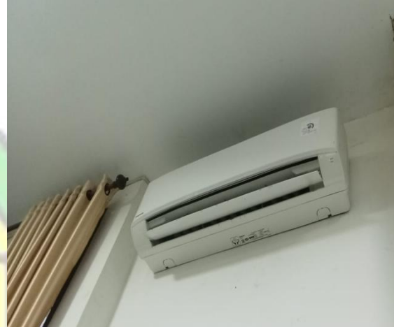
Tipe AC 2 split wall (Panasonic 1,5 PK)
