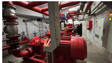
Gambar 4. 10 Hydrant Water Sumber: Dokumentasi Pribadi
