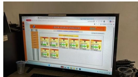
Gambar 4. 8 Lighting Control System Sumber: Dokumentasi Pribadi
