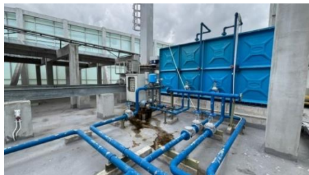
Gambar 4. 9 Tangki Air Bersih Sumber: Dokumentasi Pribadi
