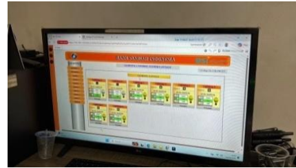
Gambar 4. 4 lighting control system Sumber: Dokumentasi Pribadi, 2026
