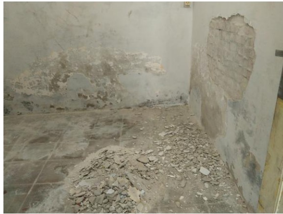
Gambar 4.12c Kondisi Kerusakan Dinding dan Lantai pada Ruang Interior Bangunan Pascatsunami 2004
