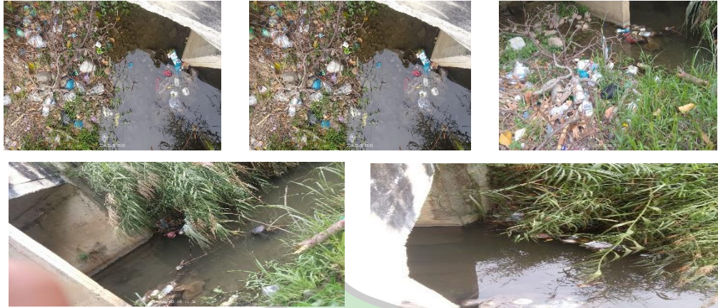
Kondisi Pembuangan Sampah di Saluran Air Sungai
