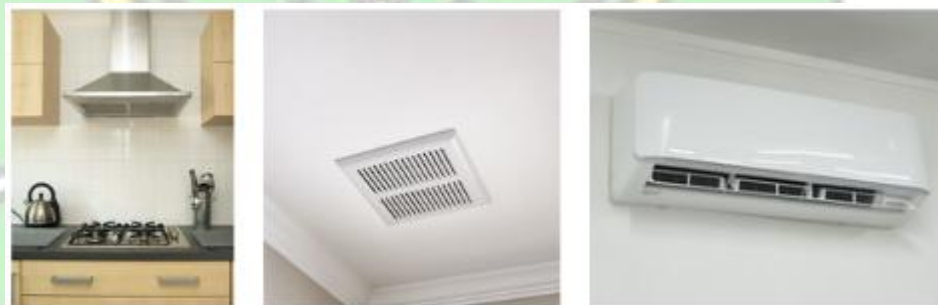
Gambar 5.43 a) exhaust fan kitchen , b) exhaust fan bathroom , c) Ac split
