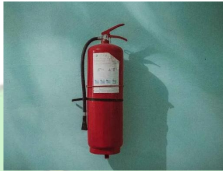
Gambar 5.38 Tabung pemadam kebakaran
