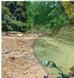
Gambar 5.13 Kondisi Jalan Menuju Desa Pining
