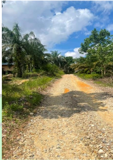
Gambar 8. Kondisi Jalan Singkohor
