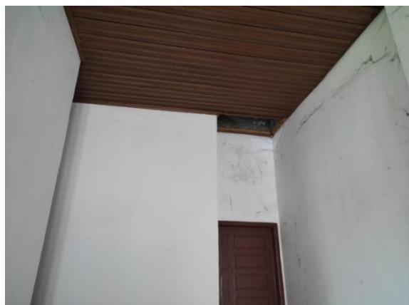
Gambar 1. 1: Kondisi ruang dalam yang kotor dan tidak terawat pada Gedung DPRD Pidie Sumber: dokumen pribadi
