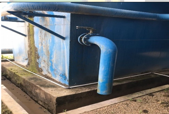
Pipa Pembuangan Lumpur Filtrasi
