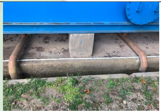
Pipa Pembuangan Lumpur Sedimentasi
