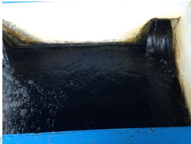
Gambar 4.4. Bak Clarifier IPA Pria Laot
