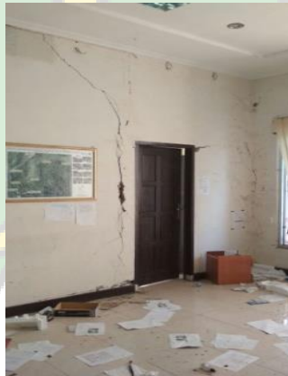
Gambar F: Dinding dalam retak
