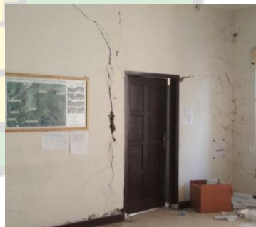
Gambar I: Dinding dalam retak
