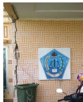
Gambar B: Kolom praktis dan balok yang rusak
