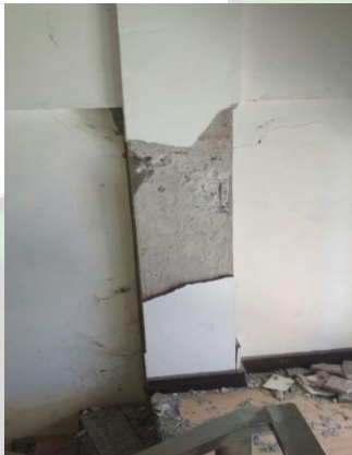
Gambar E: Beton kolom rusak
