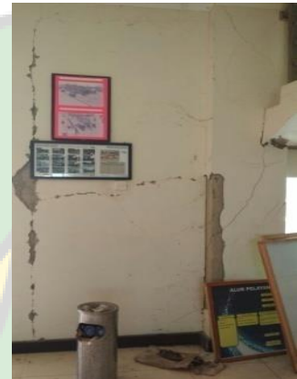
Gambar G: Dinding dalam retak
