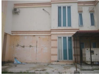
Gambar C: Kerusakan pada dinding luar
