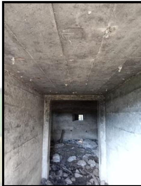
Gambar 3. 3. Posisi BML 4 di area perkebunan masyarakat, Gampong Durung. BML 4 memiliki pintu masuk dari arah selatan menuju satu ruangan. Terdapat lima lubang pengintai dari arah barat 1, timur 1, dan arah utara 3. Adanya kerusakan pada atap lubang pengintai dan dalam ruangan yang diberi dengan penanda warna merah pada gambar di atas. BML 4 ketebalan dinding berukuran 40 cm. (Dok. Penulis 1 Agustus 2021)
