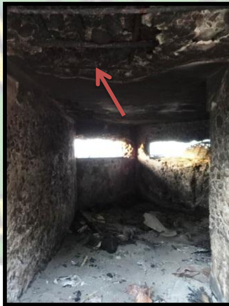
Gambar 3. 5. Posisi BML 6 berada di pantai Gampong Durung, kondisi sudah terkikis dan sudah terlihat besi di dalam struktur benteng yang diberi tanda panah. BML 6 terbuat dengan sebuah ruangan, yang terdapat dua lubang pengintaian yang mengarah ke utara dan memiliki pintu masuk dari arah selatan. BML 6 ketebalan dinding berukuran 40 cm. (Dok. Penulis 8 Agustus 2021)
