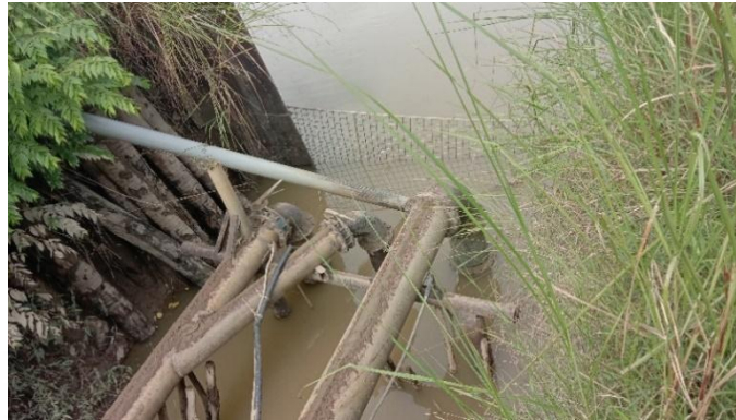
Gambar 4.3 Pompa Intake Dari Sumber Air Baku (Sumber: Dokumentasi Tugas Akhir, 2020)
