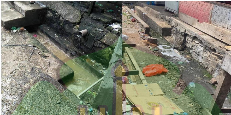
Gambar 4. 2 Kondisi drainase pasar induk lambaro
