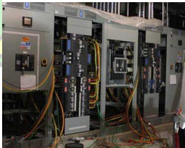
Gambar 4.34 Panel Listrik Sumber: Berempat.com
