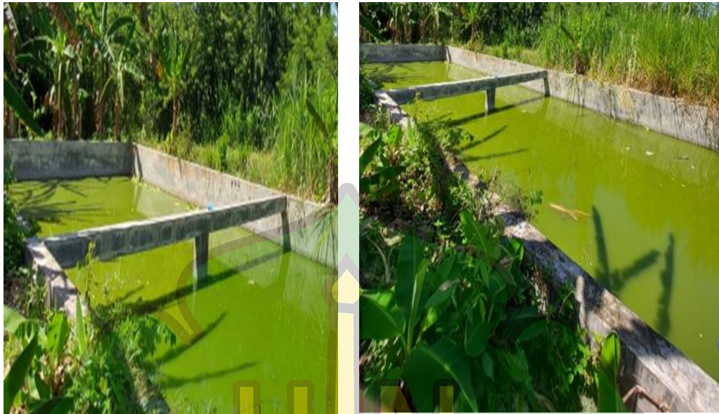
Gambar 4.4 Kondisi Eksisting Unit Kolam Maturasi
