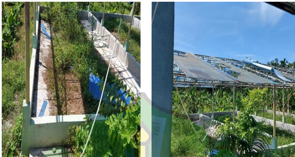
Gambar 4.5 Kondisi Eksisting Unit SDB
