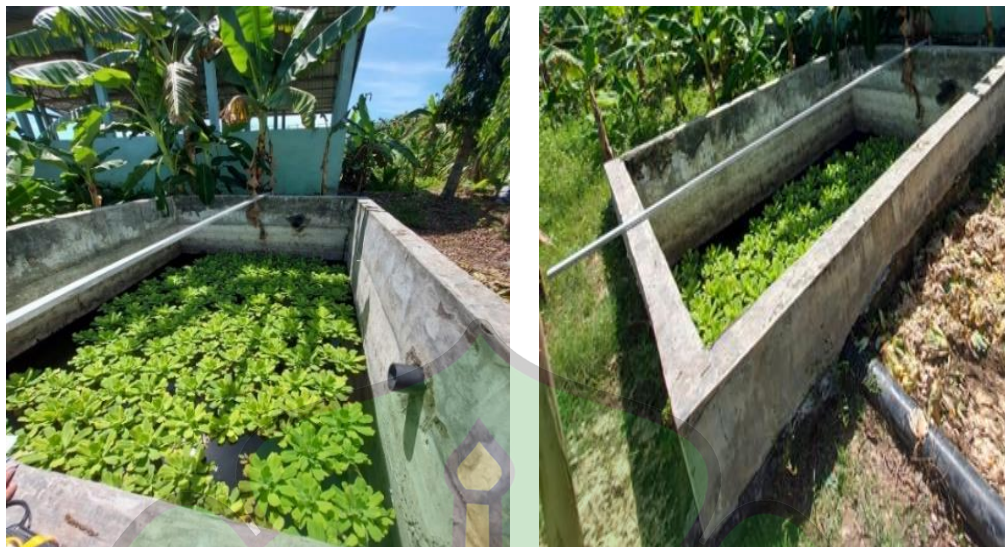
Gambar 4.2 Kondisi Eksisting Unit Kolam Anaerobik
